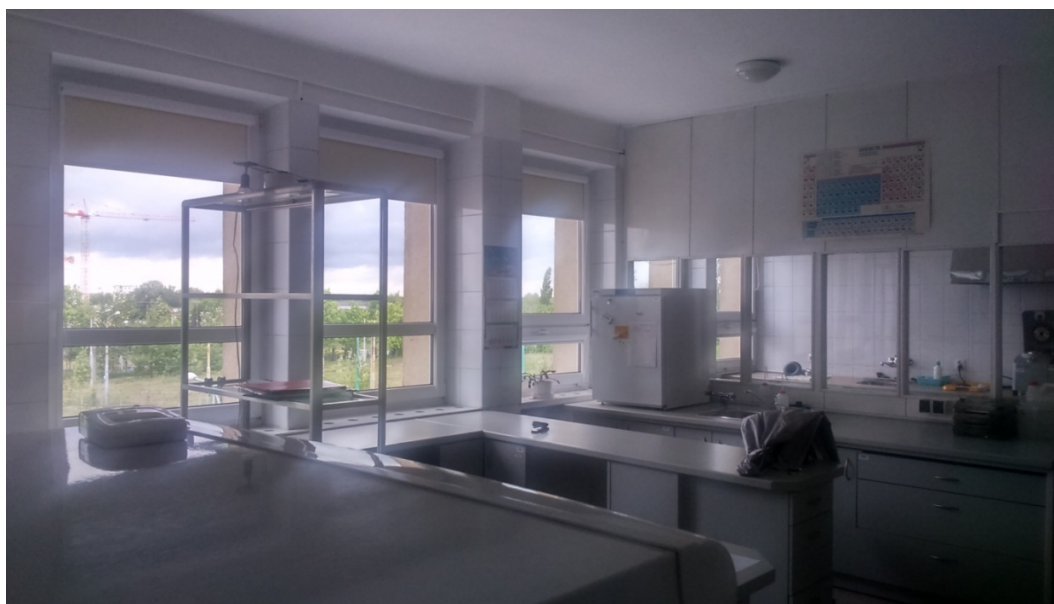
Dok. fot. nr 1/312 Ściana przeszklona, konstrukcji drewnianej, dzielącej pomieszczenie na 2 części do demontażu
