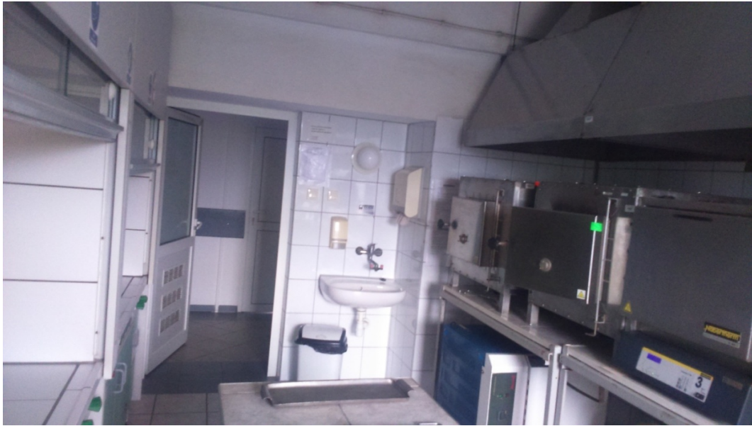
Dok. fot. nr 4/S Do wymiany bateria umywalkowa
