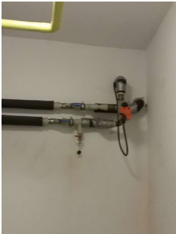
DOK.FOTO.NR1/N. Istn. instalacja wody lodowej.
