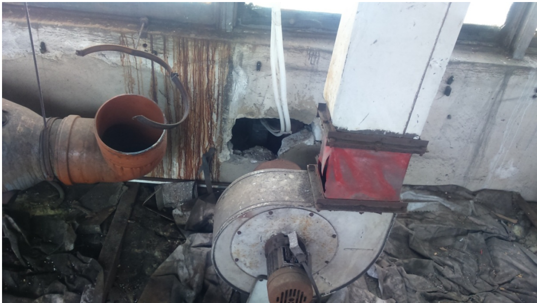
Dok. fot. nr 1/D Istniejące dziury w ścianach
